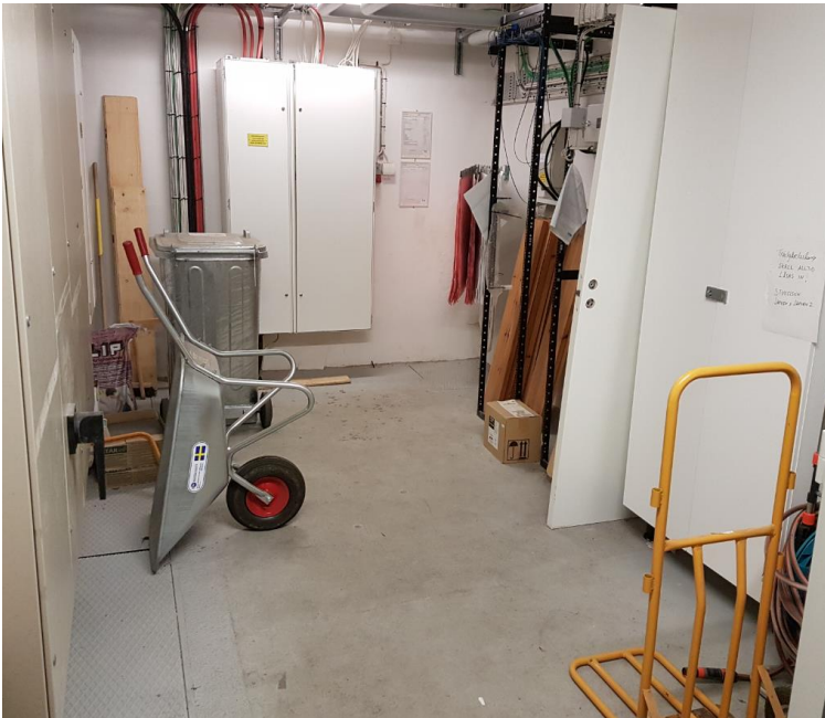
Bild 11: E18, garage, elcentral.
