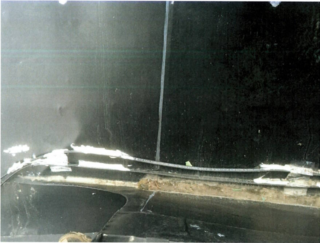
BILD 7 (detalj uppifrån obs skräp i rännal och kablar loss)
